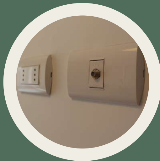
PUNTOS DE TELEVISIÓN POR CABLE ENTUBADOS
